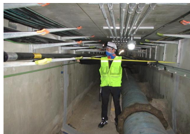
의사당로B 통신구 내부 제원측정
