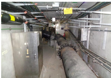
의사당로B 통신구 내부 전경
