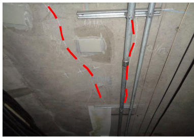
전력구 종방향 균열(cw=0.2mm)
